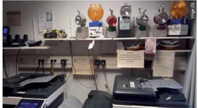
> Auch im Technikraum wird es immer enger.
