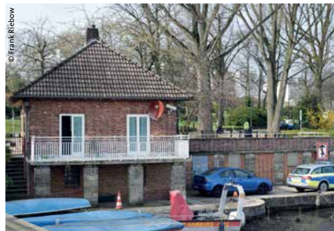
➤ WSPK 2-Außenstelle Alster: Baujahr 1947 – der Zahn der Zeit hat seine Spuren am und im Gebäude hinterlassen.
